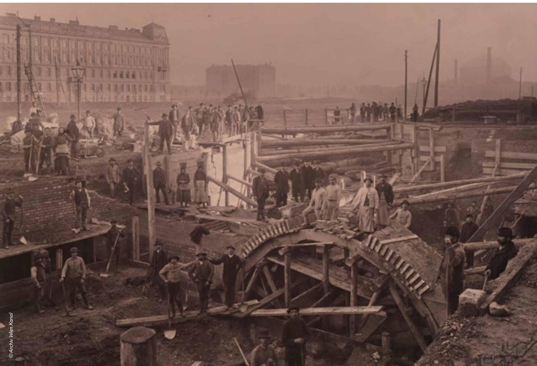
Bauarbeiten am Rechten Hauptsammelkanal am rechten Ufer des Donaukanals (Überfallkammer des Notauslasses Sofienbrücke)
