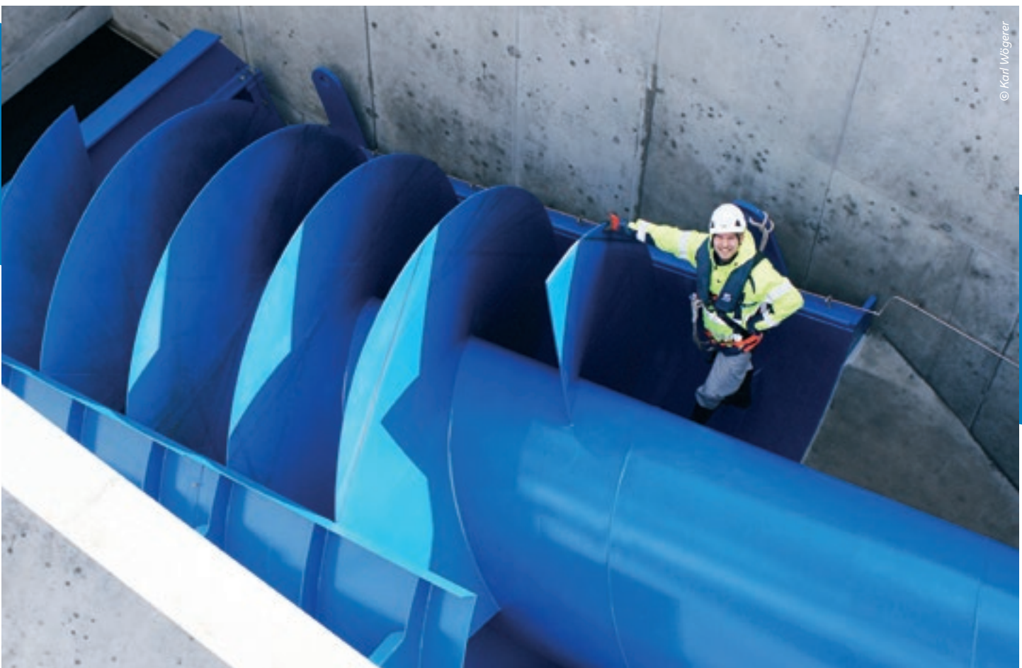
Die Wasserkraftschnecke der Wiener Kläranlage
