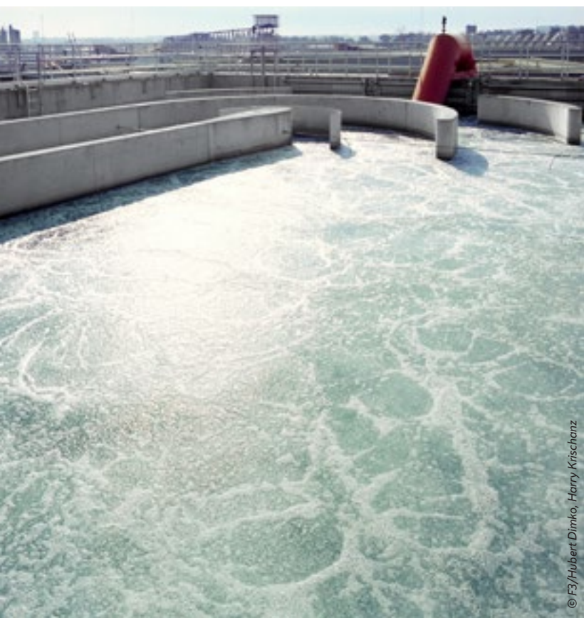
... und beim Belüftungstest mit Reinwasser
