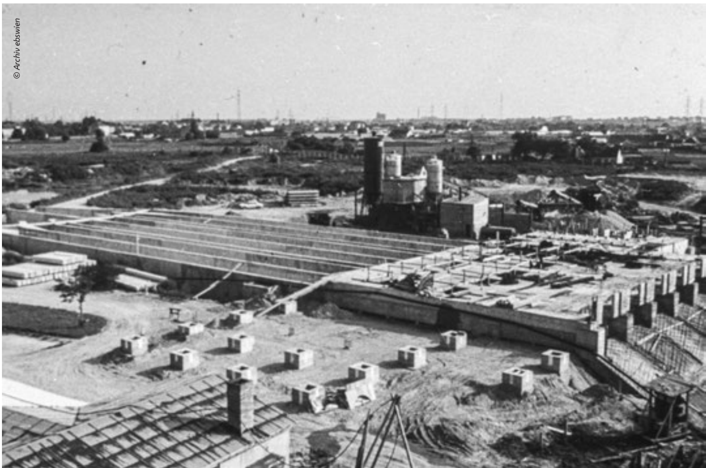
Großbaustelle Hauptkläranlage: die Becken des Sandfangs, rechts davon die Basis für die Rechenanlage
