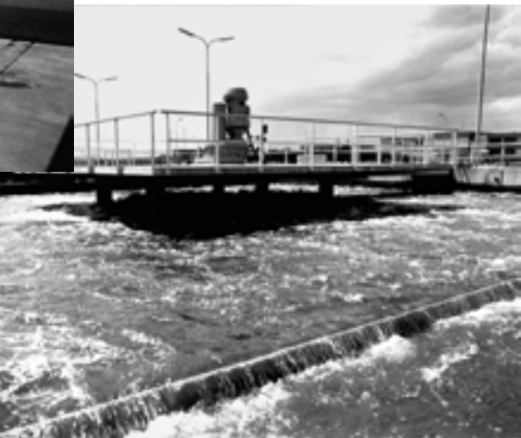
Belebungsbecken in Betrieb
