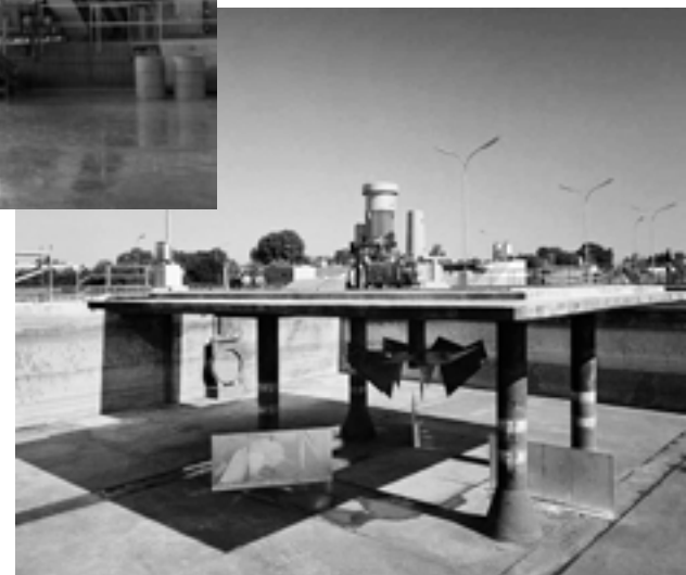
Kreiselpelüfter im Belebungsbecken
