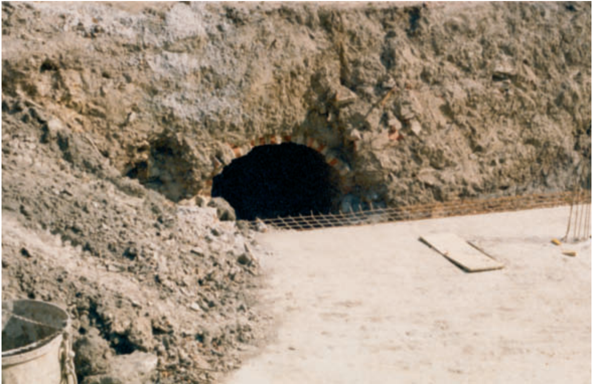
Abb. 103, 104 Reste der alten Sulzbacheinwölbung, welche im Zuge von Bauarbeiten in der Hameastraße freigelegt wurden
